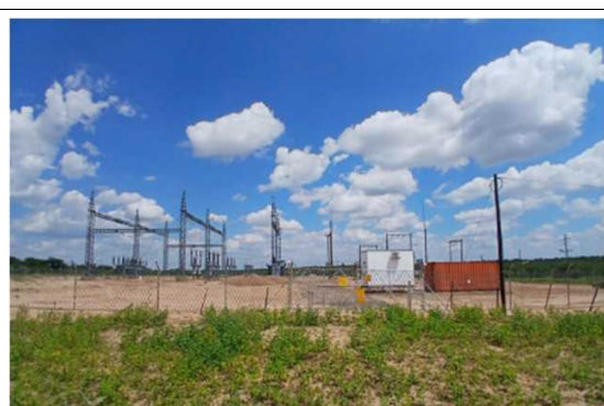
Photo 7-17 De Hoek substation
